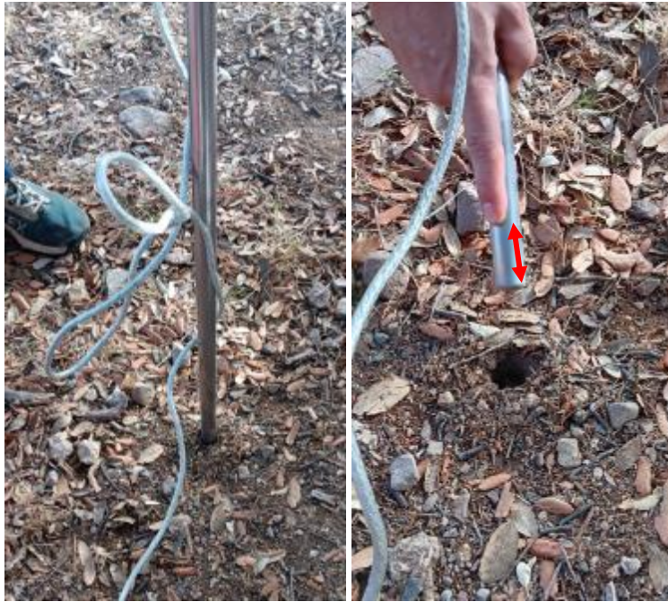
Imagen 21. Muestra de la gran compactación del terreno. Apenas se ha podido profundizar 2 cm después del golpeo con la pértiga.
